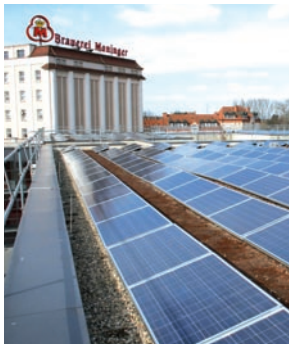
Photovoltaikanlage auf den Dächern des SINNER-Areals, Karlsruhe
